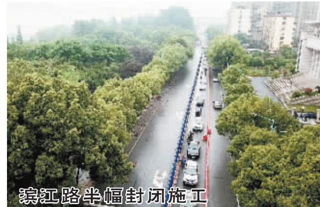
赣江路半幅封闭施工 日前,由于九江市水务有限公司铺设三水厂第二根源水管道,滨江路从河东水厂至啤酒厂2.1公里路段施工,滨江路北侧半幅路面围挡封闭,南侧半幅路面双向通行。施工时间为2019年5月12日至9月4日,遇雨顺延。(本报记者 刘家报)
