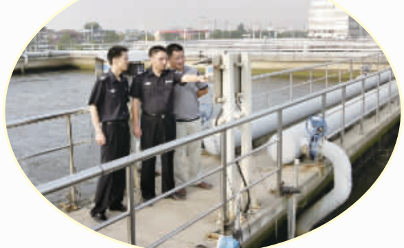
生态环境执法人员检查污水处理设施运行情况
