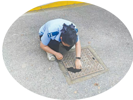
网格员欧阳旭晨用木板覆盖破损的窨井盖。
